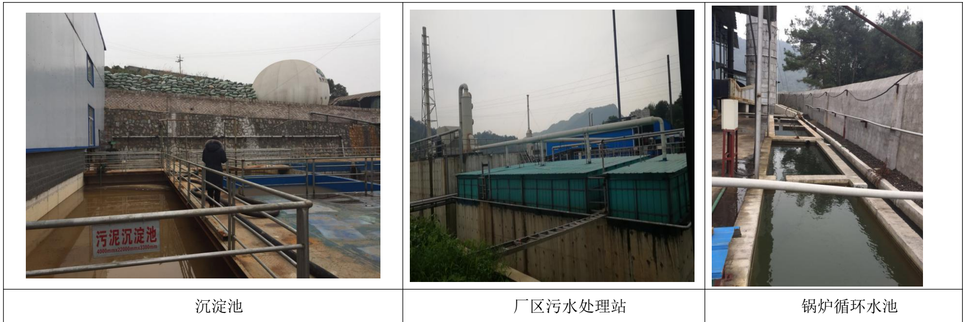
图 4.1-1 项目废水处理设施照片
