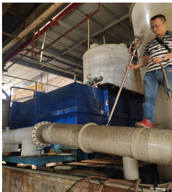
水解车间废气进口
