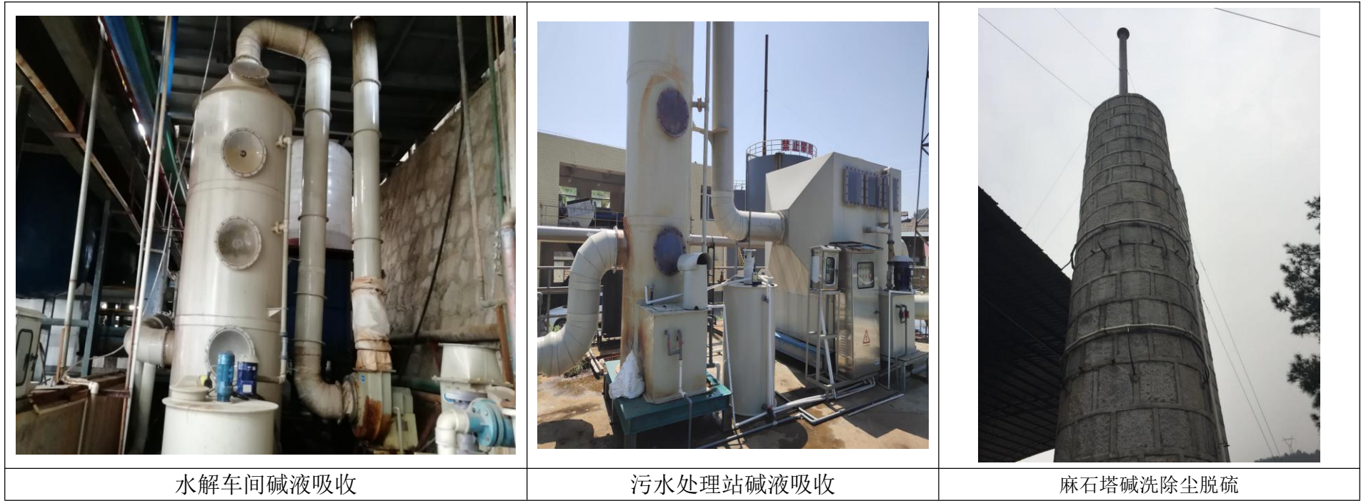
图 4.1-2 项目废气处理设施照片
