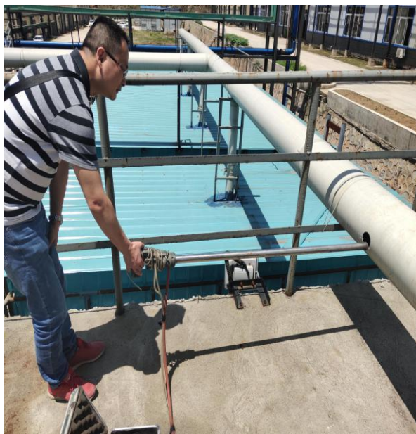
污水处理站废气进口
