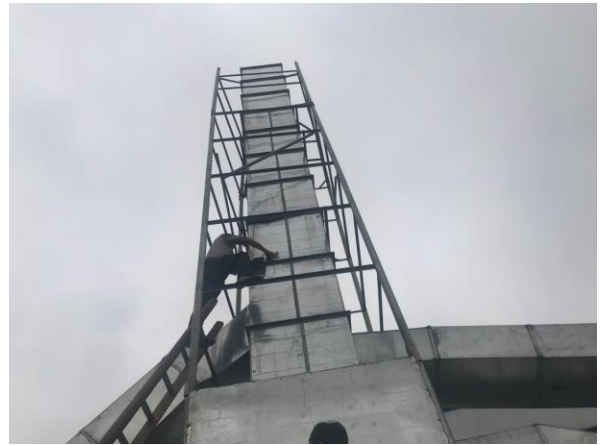
涂胶机排气筒出口
