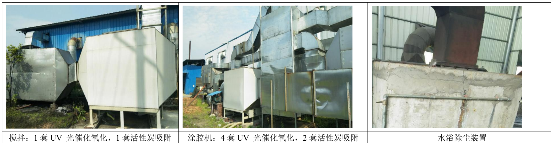
图 4.1-2 项目废气处理设施照片
