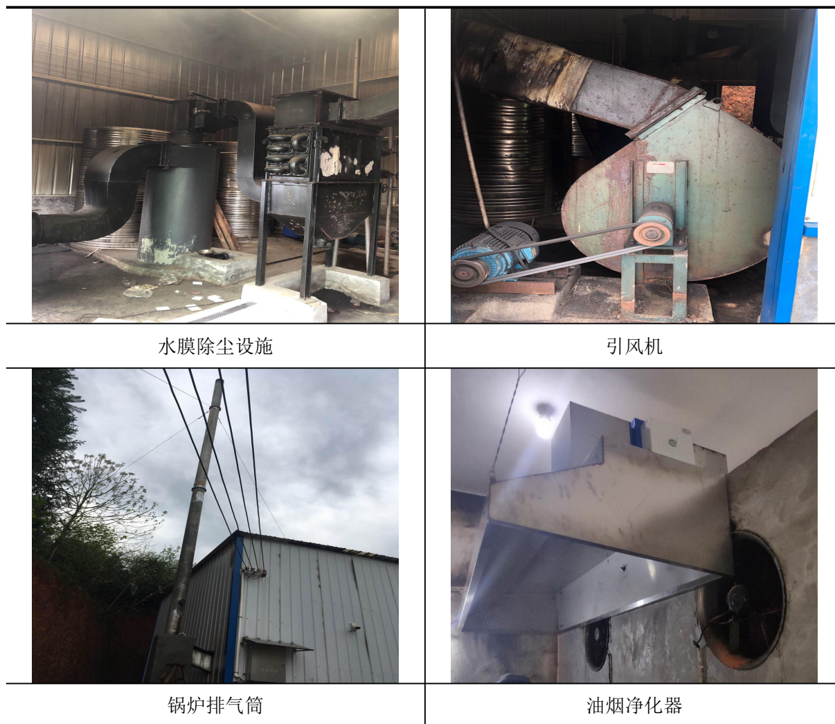
图 4-2 废气处理设施照片
