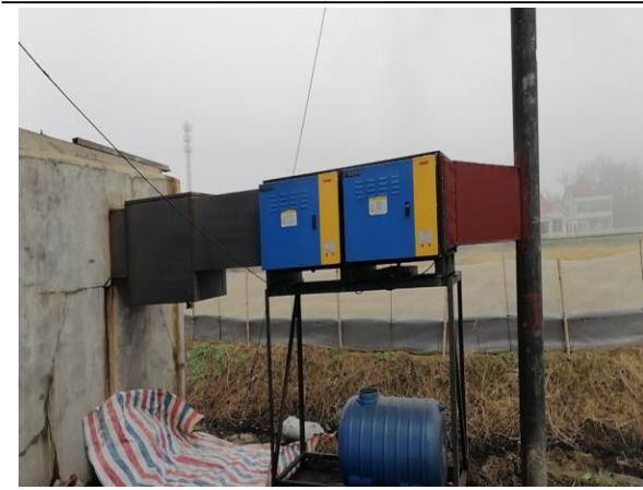
废气处理设施
