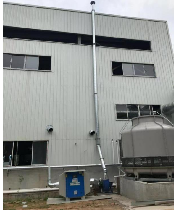
有机废气处理设施排气筒
