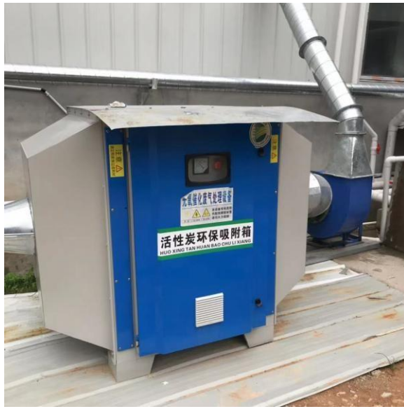
有机废气处理设施
