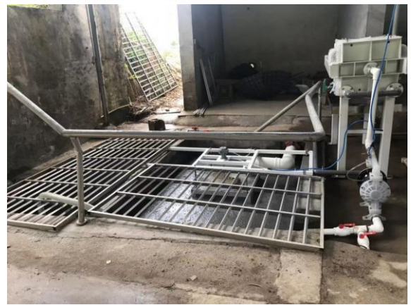
废水处理设施
